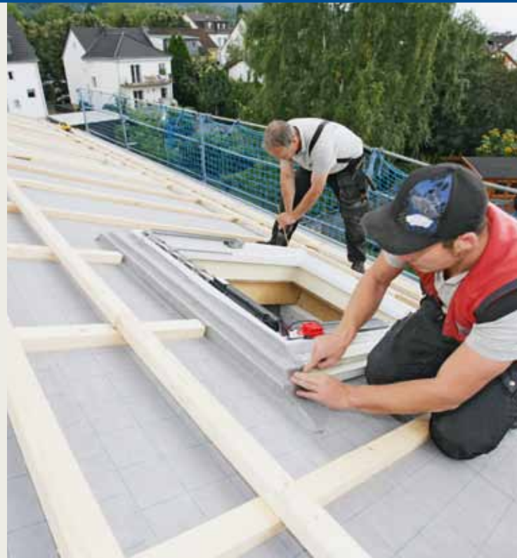
Gesicherte Wasserführung oberhalb des Dachfensters
